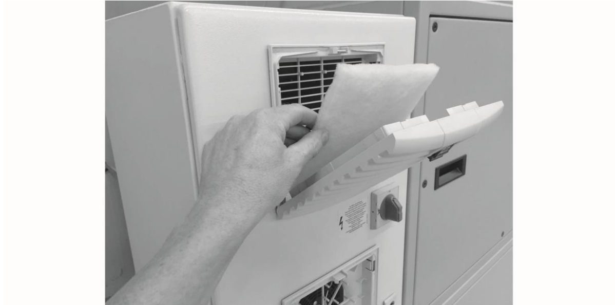
Bild 39: Filterbyte i kopplingsskåp
